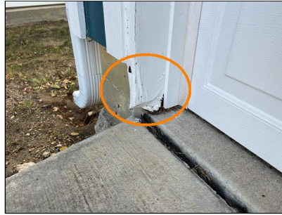
G. Item 2 Garage door, left side
