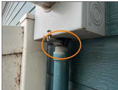
A. Item 1 Conduit at electrical meter
