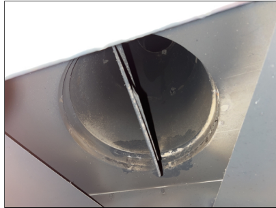
J. Item 2 Fireplace damper
