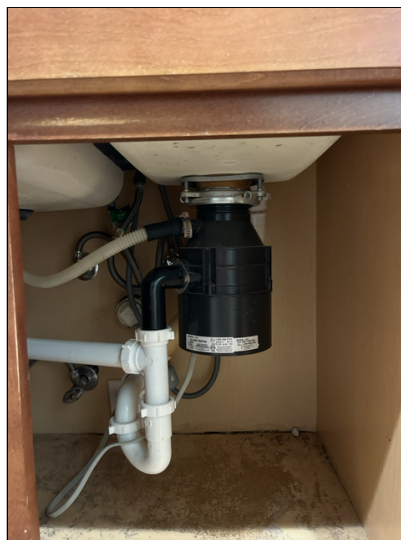
B. Item 1 Garbage disposal
